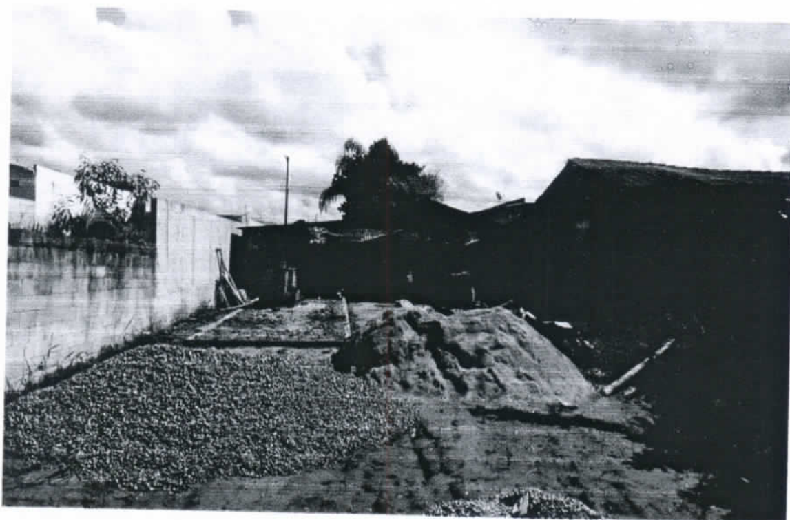
CONSTRUÇÃO ILEGAL NA RUA NORUEGA ENTREE A RODOVIA E O RIO (BALNEÁRIO SÃO JOSÉ) BALNEÁRIO DE NUMERO 14.
